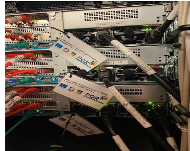
dettaglio server e schede di rete
